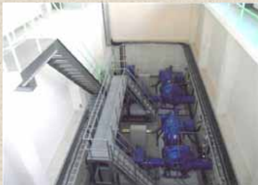
揚水機(ポンプ) 川の水を汲み上げ導水を行う。
